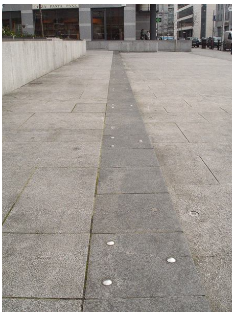
Fot. 6.45. Metalowe detale „wtopione” w stopień schodka sugerujące osobom niewidomym różnice poziomów (Źródło: www.miejsca.org )
